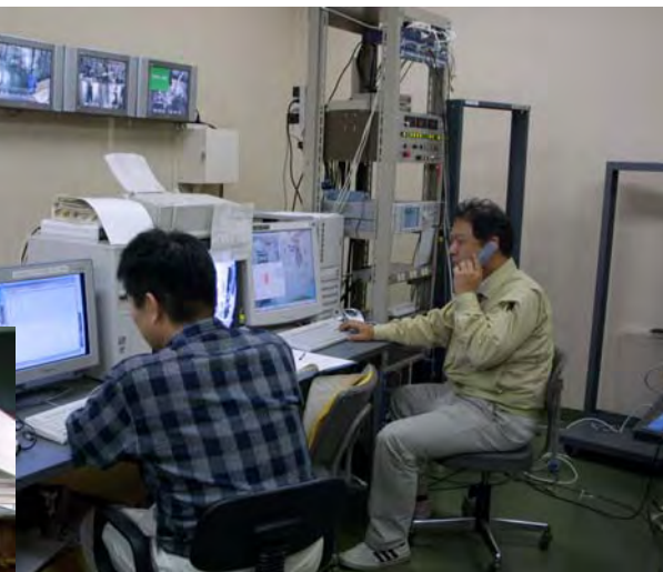
コントロール ルーム
